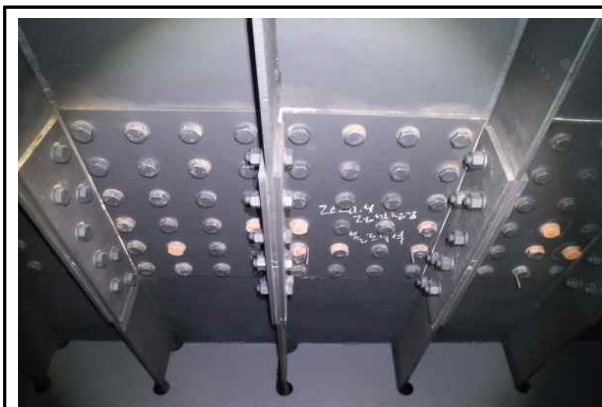
내부 누수흔적 및 볼트부식 (상행 S2 G2 UF)
